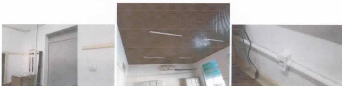
Vista da sala de informática com pontos de iluminação e tomadas.
