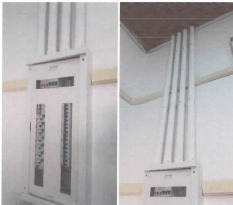
Quadro de energia em sala de informática.
